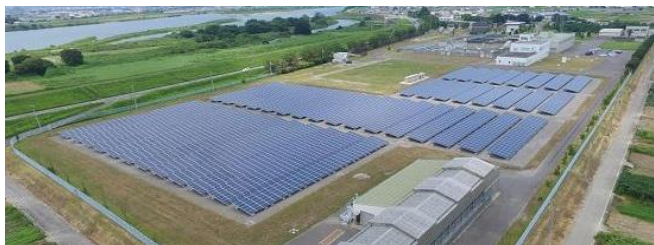
太陽光発電設備（第十浄水場）
