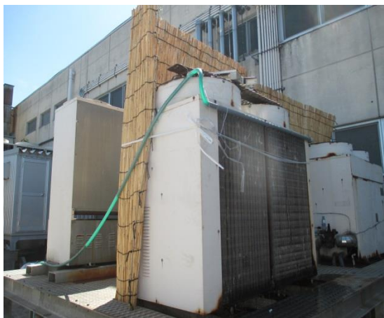
(1) 大動物懸肉室（R-12）冷蔵設備
