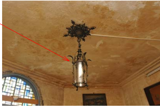
099 2階廣間階段室 ペンダントライト
