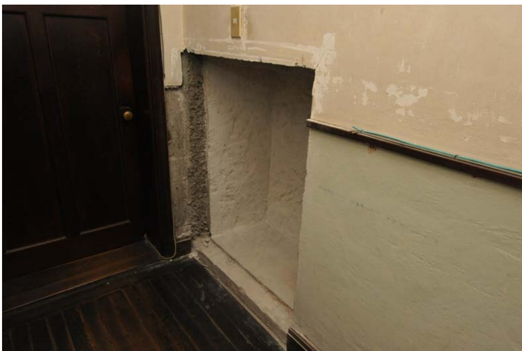
056 1階廊下 造付棚欠失
