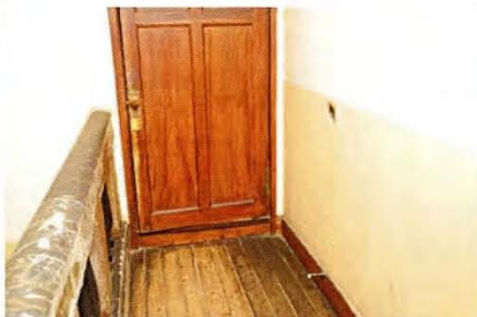
18 廊下壁面に扉金具による欠損 廊下壁面に扉金具が当って、欠損している。巾木に戸当たりが取付けられているが機能していない。
