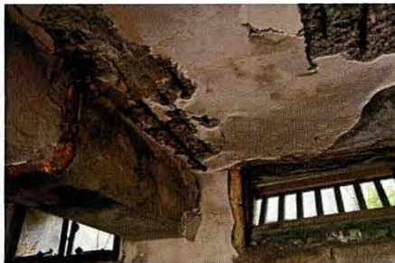
31 鉄筋コンクリート天井の爆裂 ボイラーが設置されている箇所の天井。モルタル塗が広範囲で剥落し、鉄筋が露出している。鉄筋には錆が見られる。
