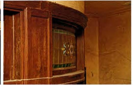
03 欄間ステンドグラスの湾曲 玄関木製建具。経年によりステンドグラスが玄関階段室側に湾曲し突出している。
