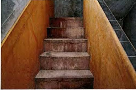
25 鉄筋コンクリート階段の亀裂 鉄筋コンクリート階段の蹴込部分、横方向に一定の亀裂が生じている。
