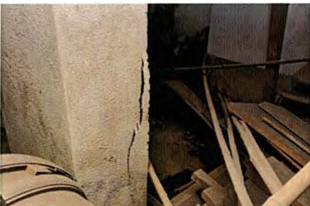
30 鉄筋コンクリート柱の爆裂 鉄筋コンクリート柱に見られる爆裂。
