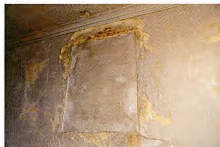
13 漆喰塗壁に亀裂、上塗の浮き 夫人室緑側の漆喰壁に亀裂、上塗の浮きがみられる。経年による劣化に加え、雨漏りも破損原因と考えられる。
