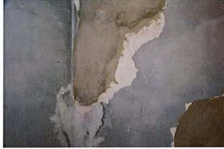
26 鼠漆喰上塗の浮き 塔屋階段室壁面の鼠漆喰上塗が浮いている。補修跡、雨染みも散見される。
