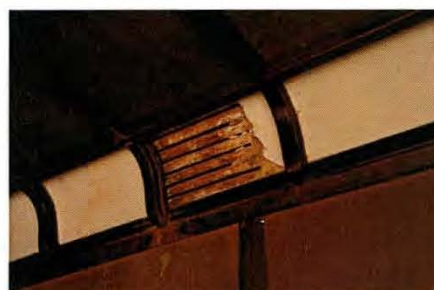
12 折上天井漆喰の剥落 夫人室の折上天井部分の漆喰が剥落している。周辺には雨染みが見られることから雨漏りが原因と考えられる。
