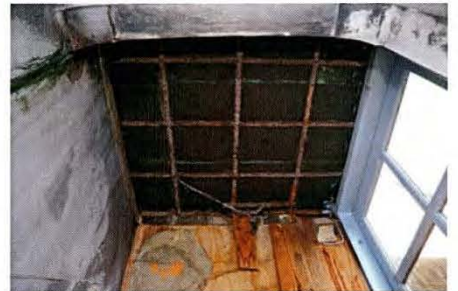
29 鉄製格子戸の発錆 塔屋への出入口、鋼製格子戸に錆が見られる。周囲には雨染みが生じており、降雨時の恒常的な雨漏りが考えられる。
