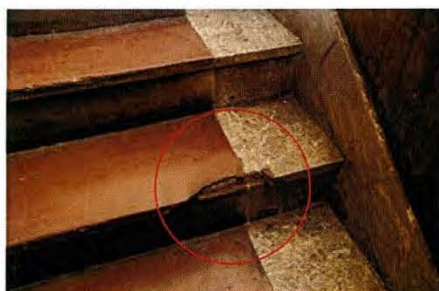
14 石階段踏面に欠損 階段踏面の石部分、モルタル部分が欠損している。写真箇所以外にも軽度ではあるが同様の破損が散見される。
