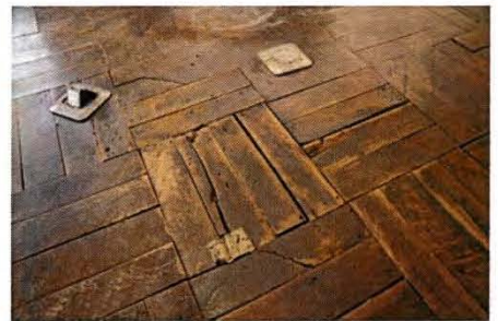
05 寄木貼の浮き、割損 食室、部屋中央部の寄木貼に浮き、割れがみられる。浮いた板は脳天釘打ちにて姑息的に修繕している。
