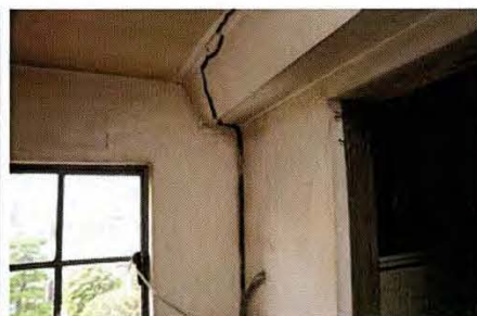
15 増築トイレ隅部に著しい亀裂 増築トイレと当初壁面との取付き部分に天井から床に至る大きな亀裂が東西両端に生じている。
