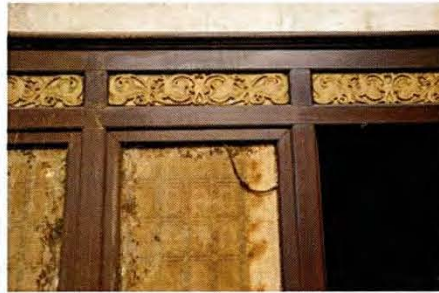
02 石膏彫刻、壁紙の汚損 主人書斎兼客室の壁面。経年によって石膏彫刻の表面が変色しており、壁紙にも汚損がみられる。またパイピングコードがはずれかかっている。
