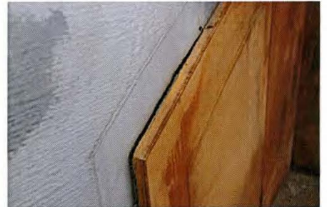
28 腰壁造作の脱落 塔屋階段壁面、壁部分造作の広い範囲に、脱落、浮きが見られる。
