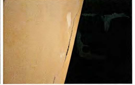
27 階段庇桁部コンクリートの割損 階段庇桁部コンクリートに割損が見られる。
