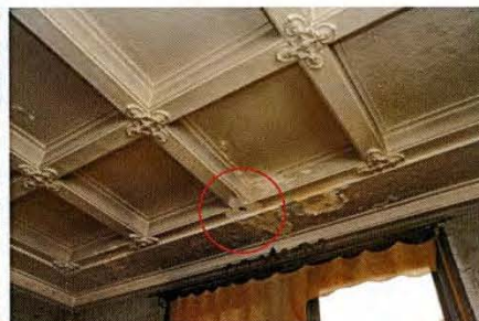
11 天井仕飾り漆喰の脱落 球突室、東寄りの天井仕飾りが脱落している。周辺には雨染みも見られる。経年による劣化に加え、雨漏りの影響も考えられる。
