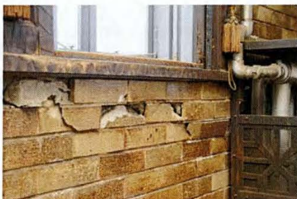
10 壁タイル張りの割損、脱落 球突室北側壁面、腰部分タイル貼の割損、脱落。タイル貼下部のコンクリート躯体の爆裂による影響と考えられる。
