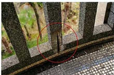
09 手摺りコンクリートの爆裂 ベランダ手摺部分で、コンクリートの爆裂が見られる。鉄筋の錆膨張による破損。かぶり厚の薄いことが見て取れる。
