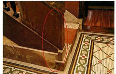
04 階段手摺部に亀裂 原因は不明だが、階段手摺部から踏段、巾木にかけて亀裂が生じている。
