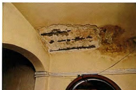
21 天井漆喰の剥落、汚損 破損「20」のすぐ南側部分。同様の破損を生じている。天井が剥落し、鉄筋が露出している。錆も確認できる。
