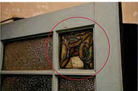
06 建具ガラスの割損 便所木製建具のステンドグラスが割損している。
