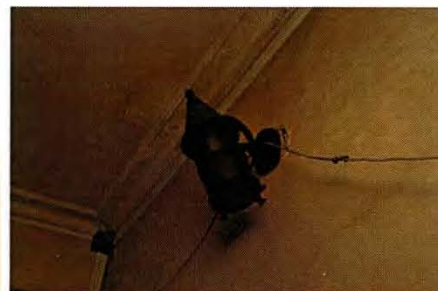
19 ブランケット照明の脱落 階段室東側に取付くブランケット照明が脱落している。経年によるもの。
