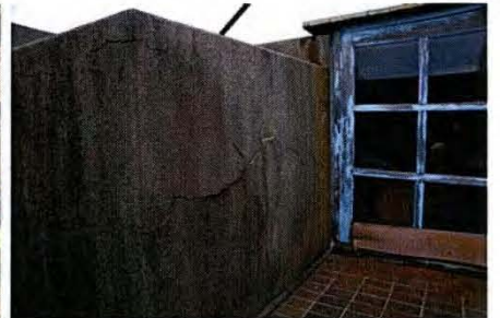
32 塔屋鉄筋コンクリートに亀裂 塔屋部に横方向に長い亀裂が見られる。亀裂は表面モルタルに生じているが、躯体にまで及んでいる可能性がある。
