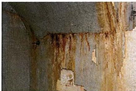
07 タイル剥落、錆汁による汚損 浴室モザイクタイルが多くの部分で浮きあがっている。また、鉄筋コンクリート躯体からの錆汁により汚れが生じている。
