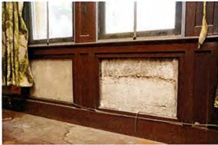
01 漆喰壁の剥落 主人書斎兼客室の壁面、腰部分の漆喰壁が剥落している。窓下の位置で、床面にも雨染みがあり、窓台からの雨漏りが直接の破損原因と考えられる。
