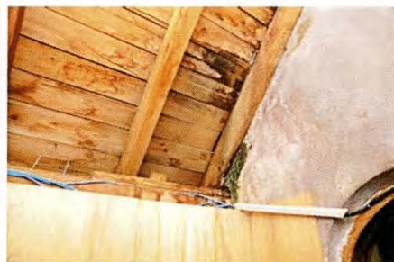
23 天井板の漏水汚損 温罐室天井南西部分に漏水による汚損が確認できる。現在も降雨時には雨が染みている状態。
