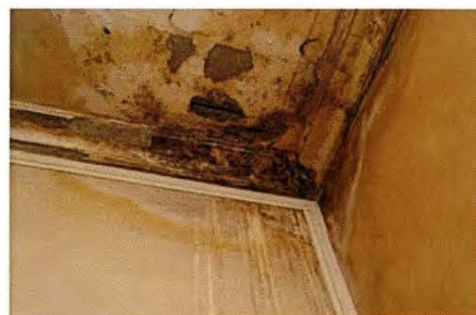
20 天井隅部の漏水汚損 階段室天井南東隅部分の漏水による汚損。コンクリートの爆裂も確認できる。現在はこの箇所からの漏水は止まっている様子。
