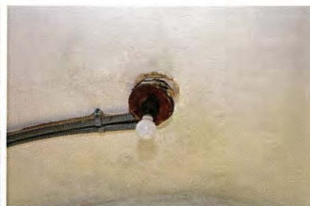
24 照明台座の脱落 洗面室照明の台座及び配線が脱落している。経年によるもの。
