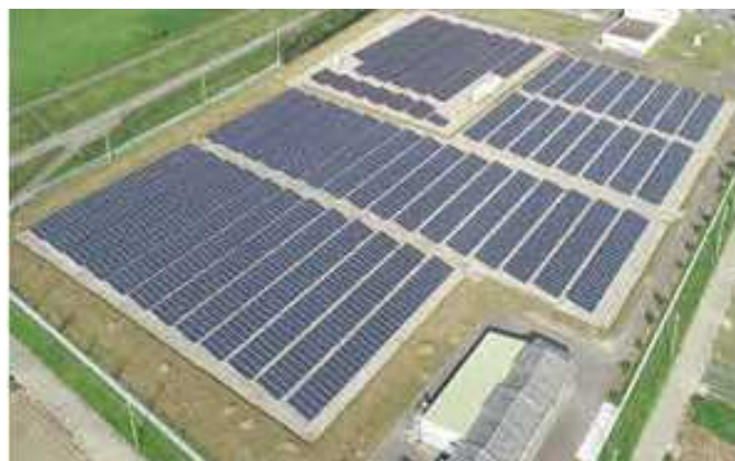
図3.6 太陽光発電設備
