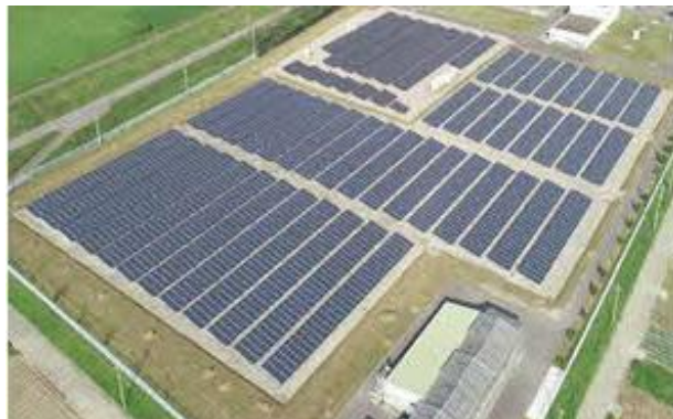
図 3.6 太陽光発電設備
